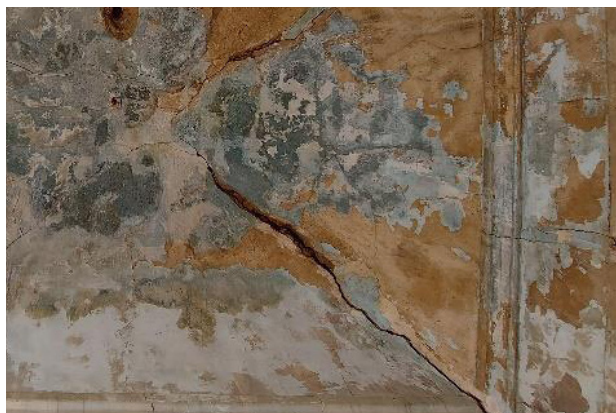
Fig. IV-46. Fotografia soffito con infiltrazioni © UNESCO
