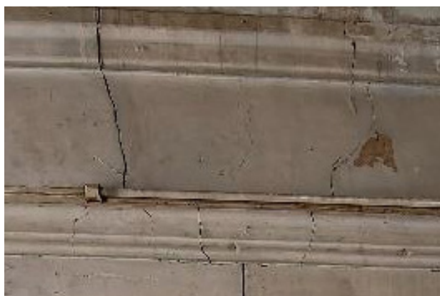
Fig. IV-44. Fotografia fissurazione ©UNESCO
