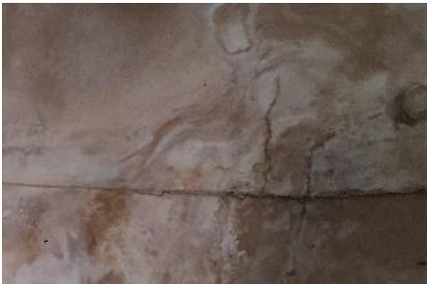
Fig. IV-43. Fotografia efflorescenza ©UNESCO
