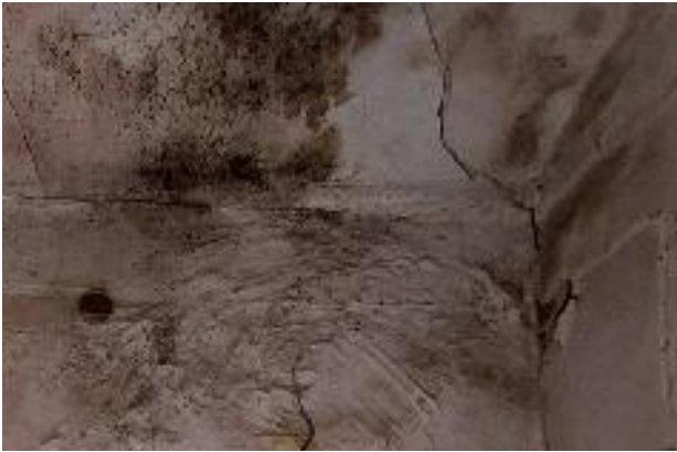
Fig. IV-53. Fotografia infiltrazione ©UNESCO
