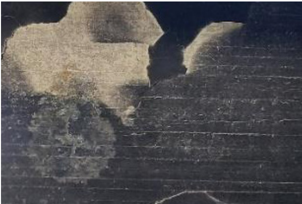
Fig. IV-49. Fotografia soffito bruciato ©UNESCO
